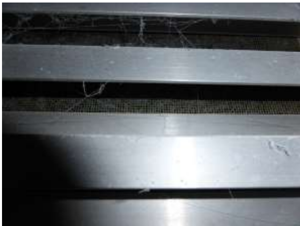
Lüftungsgitter im Treppenabgang, fein vergittert. (Foto von 2014)
